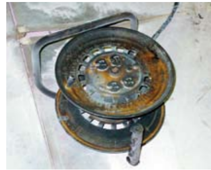
引火の元となった電工ドラム
