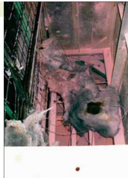
引火した空調機フィルタ
