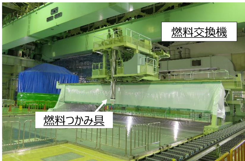
燃料交換機 全景写真
