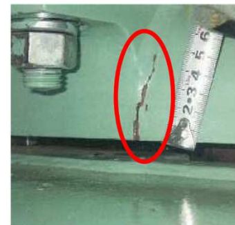
き裂箇所（写真）
