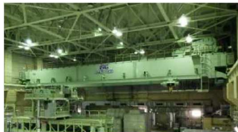
天井クレーン全景（写真）
