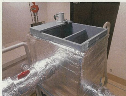
放水口モニタ混合槽(2号機)
