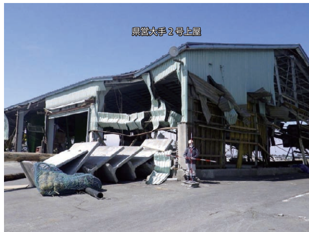
県営大手2号上屋の被災状況
