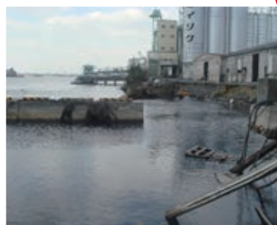
飼料会社護岸の被災状況
