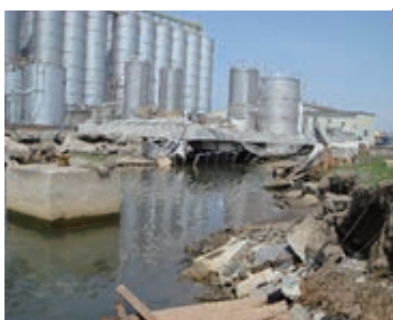
食用油会社護岸の被災状況
