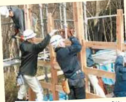
2 粘り強く柔構造の伝統工法の軸組み「若い職人の育成にも全力を注ぐ」
