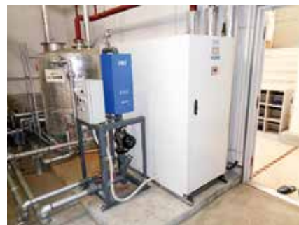
▲無薬注の水処理装置
