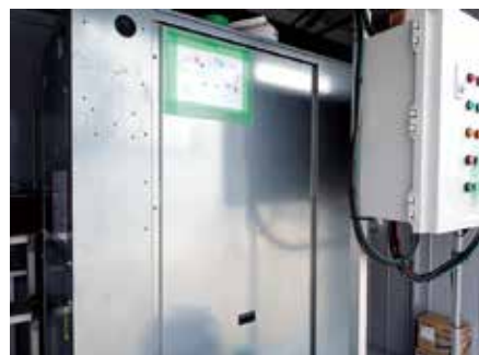
▲ヒートポンプチラー（新規）
