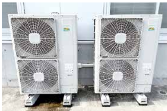
▲空調設備更新後
