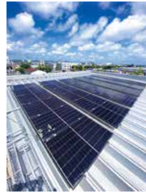
▲太陽光パネル
