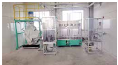
▲廃消火器のリサイクル処理設備
