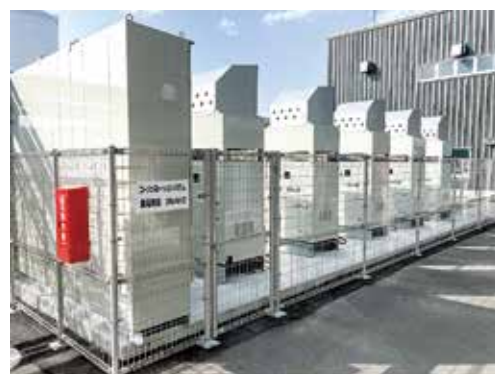
▲コージェネレーションシステム (35kW×5台)
