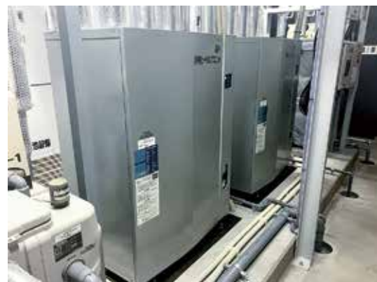
▲地中熱ヒートポンプ
