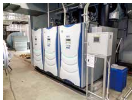
▲更新した高効率ボイラー
