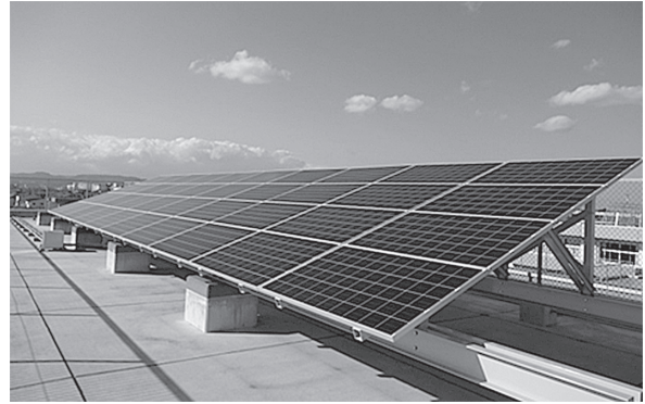
▲ 下増田小学校に設置の太陽光発電設備
