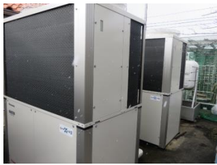
高効率空調機（室外機）
