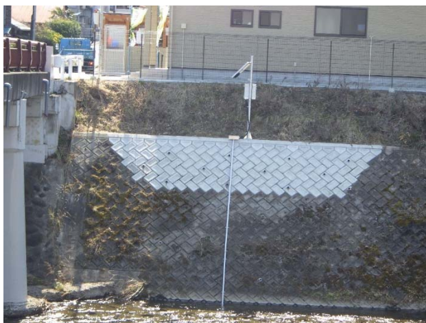
図：危機管理型水位計設置状況(七北田川 馬橋)
