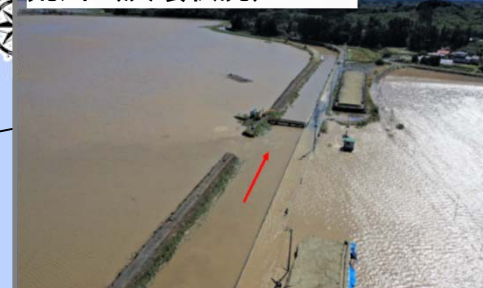
砂押川（決壊状況）
