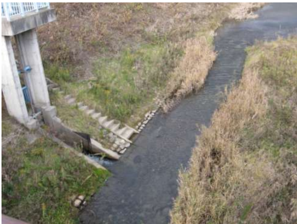
護岸ブロックの上に覆土を実施し，植生の確保をしている例（南沢川）
