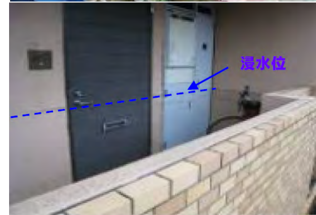
石神井川沿川の被災状況
