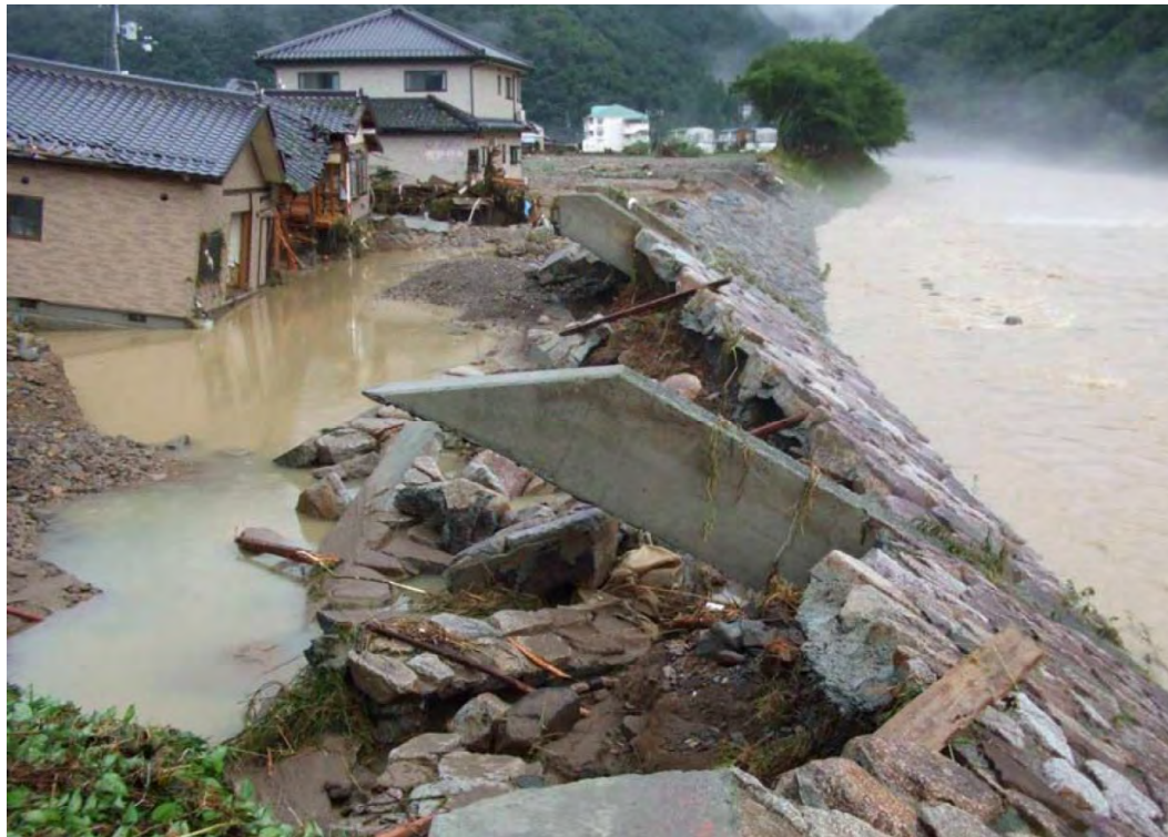
千種川水系佐用川沿川の久崎地区の被災状況 (兵庫県佐用町)
