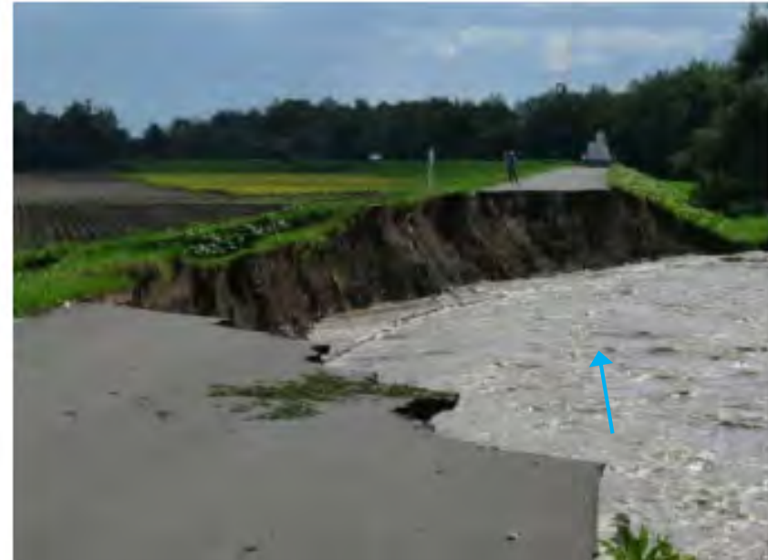
堤防流出箇所状況
