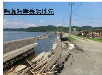
堤防の被災状況(東松島市)
