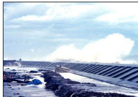
堤防に打ち寄せる高波浪（東松島市）
