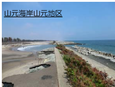
堤防の被災状況(山元町)
