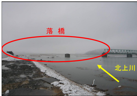
新北上大橋(左岸取付部)の落橋 (平成23年3月16日撮影)
