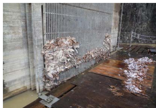
取水口への枯葉の付着(花山ダム)
