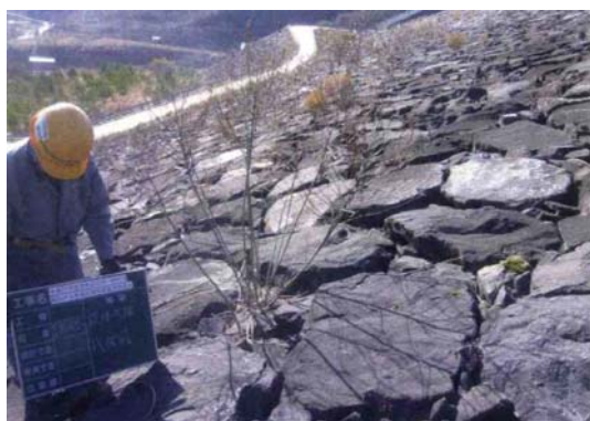
堤体への樹木進出(荒砥沢ダム)
