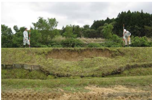
堤防の裏欠(照越川、H21 出水)
