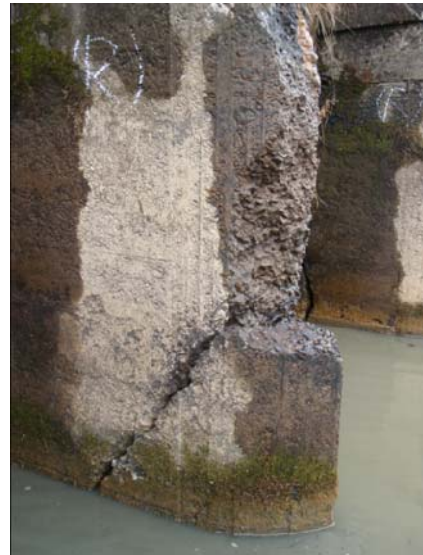
コンクリートの劣化(山吉田水門)
