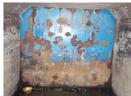
ゲートの腐食(山吉田水門)
