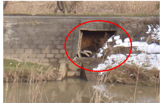
護岸の損傷(荒川)
