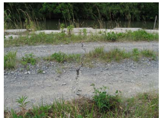
堤防のクラック(岩手・宮城内陸地震)
