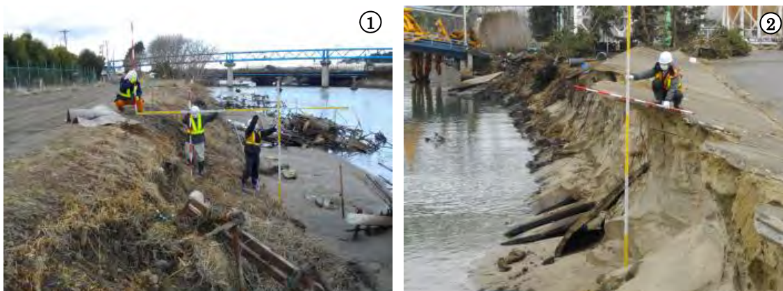
砂押川護岸の被災状況
