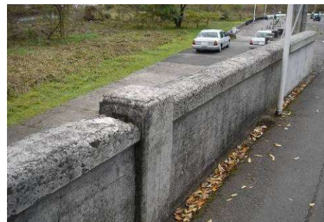
花壇自動車学校前の堤防の損傷・劣化状況 平成24（2012）年5月
