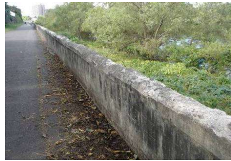
広瀬橋上流の堤防の損傷・劣化状況 平成24（2012）年5月
