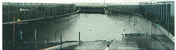
N 7 水に埋った県道塩釜—亘理線の仙台空港トンネル
