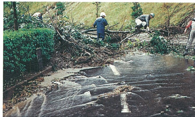
N 4 名取市高館熊野堂字岩口上／法面が崩落し土砂が道を埋めた、市道熊野堂一那智が丘線
