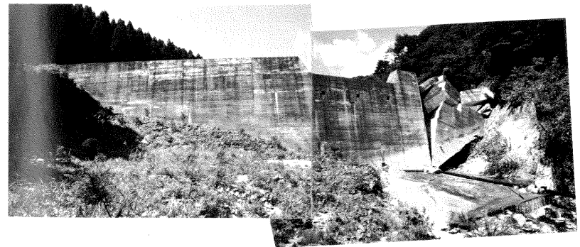
鳴子町沼井地内江合川右支築沢川(砂防ダム袖穴壊)
