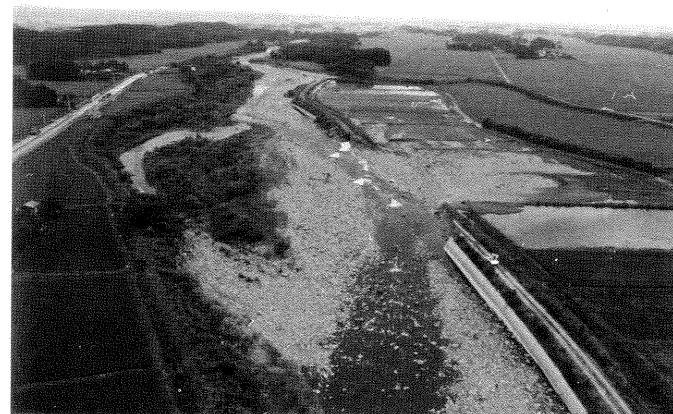
鳴瀬川水系保野川（色麻町） 河岸の欠壊
