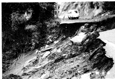
国道349号丸森町西風沢地内(崩壊)
