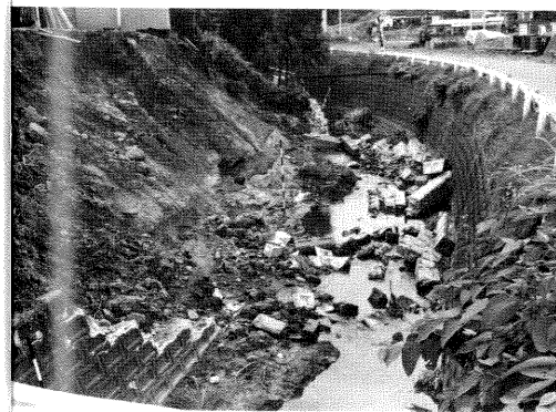
ブロック崩壊した仙台市鶴ヶ谷都市下水路
