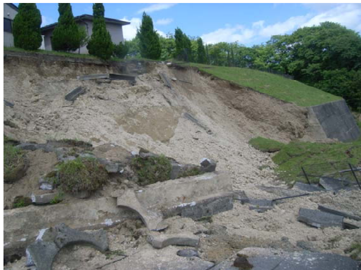
写真3-4-4 被災状況（法面の滑落・崩壊）
