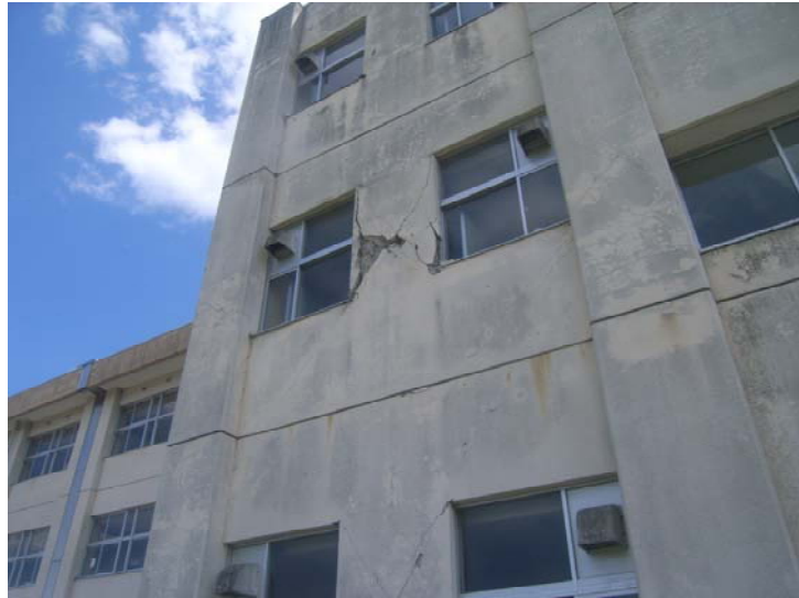
写真3-4-3 被災状況（鉄筋コンクリート造柱のせん断破壊によるひび割れ・剥落）
