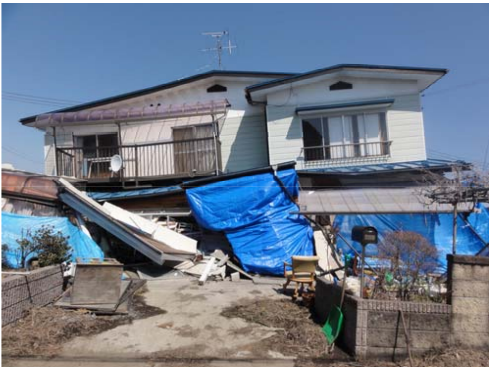
写真4 被災状況（木造建築物の倒壊）
