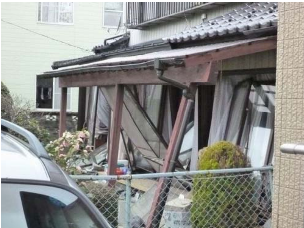
写真6 被災状況（建具の破壊，下屋部分の柱の傾斜）
