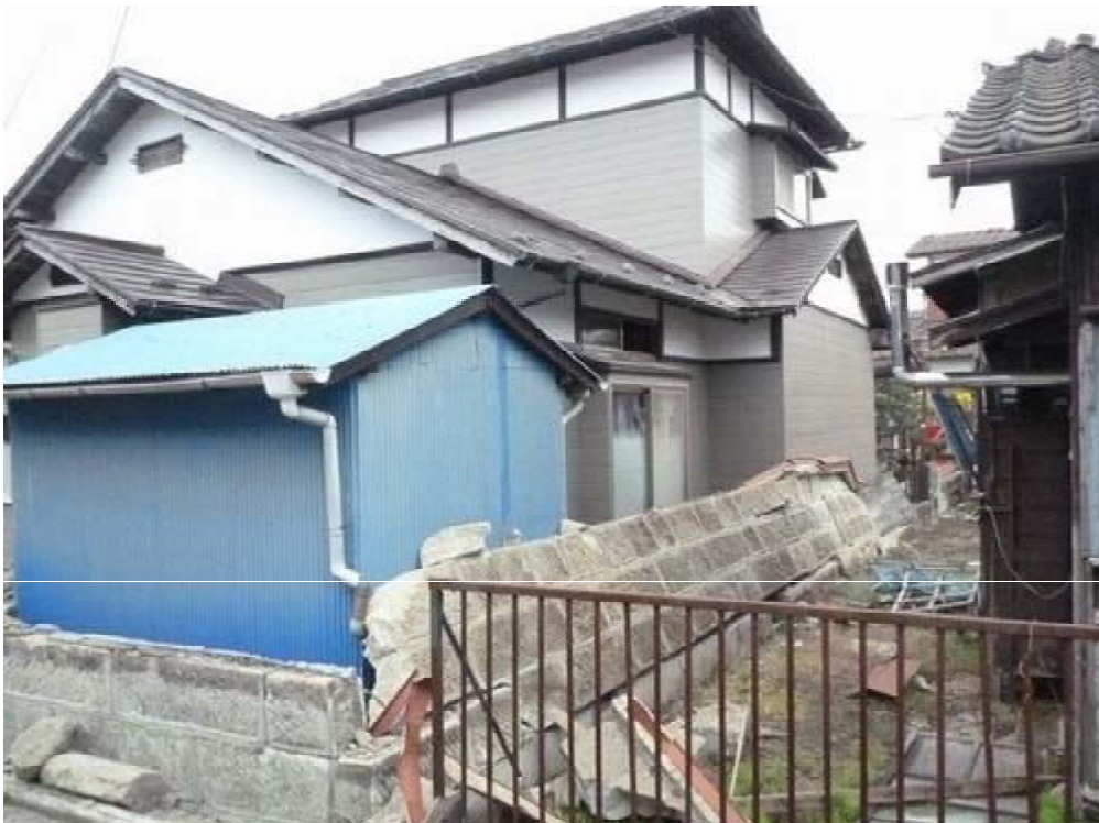
写真10 被災状況（ブロック塀の倒壊）
