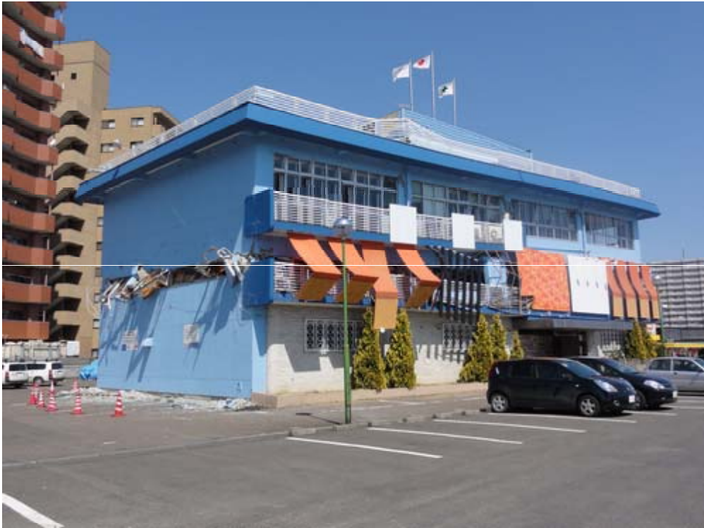
写真3 被災状況（RC 建築物の落階）
