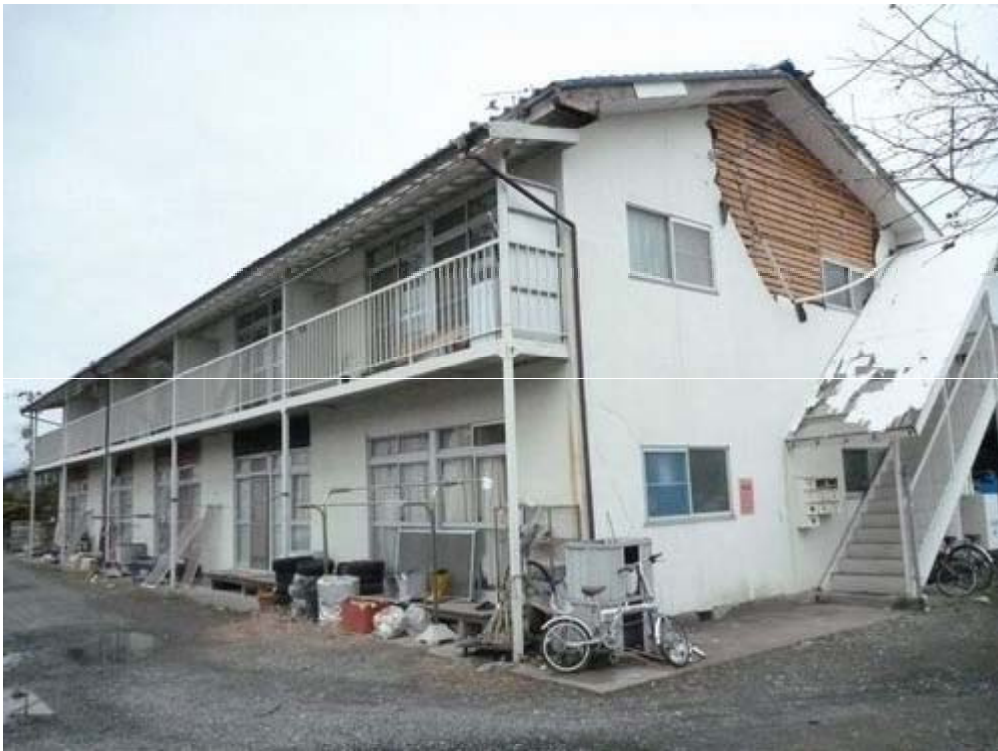
写真7 被災状況（外壁の剥落）
