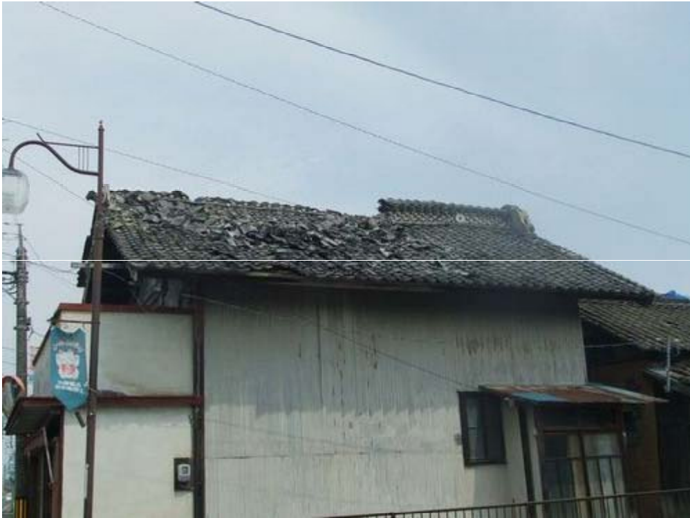
写真9 被災状況（瓦のずれ，落下）
