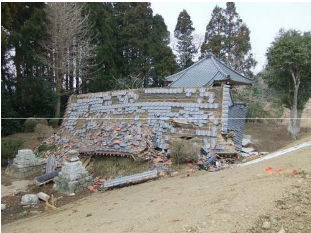
写真2 被災状況（木造建築物の倒壊）
