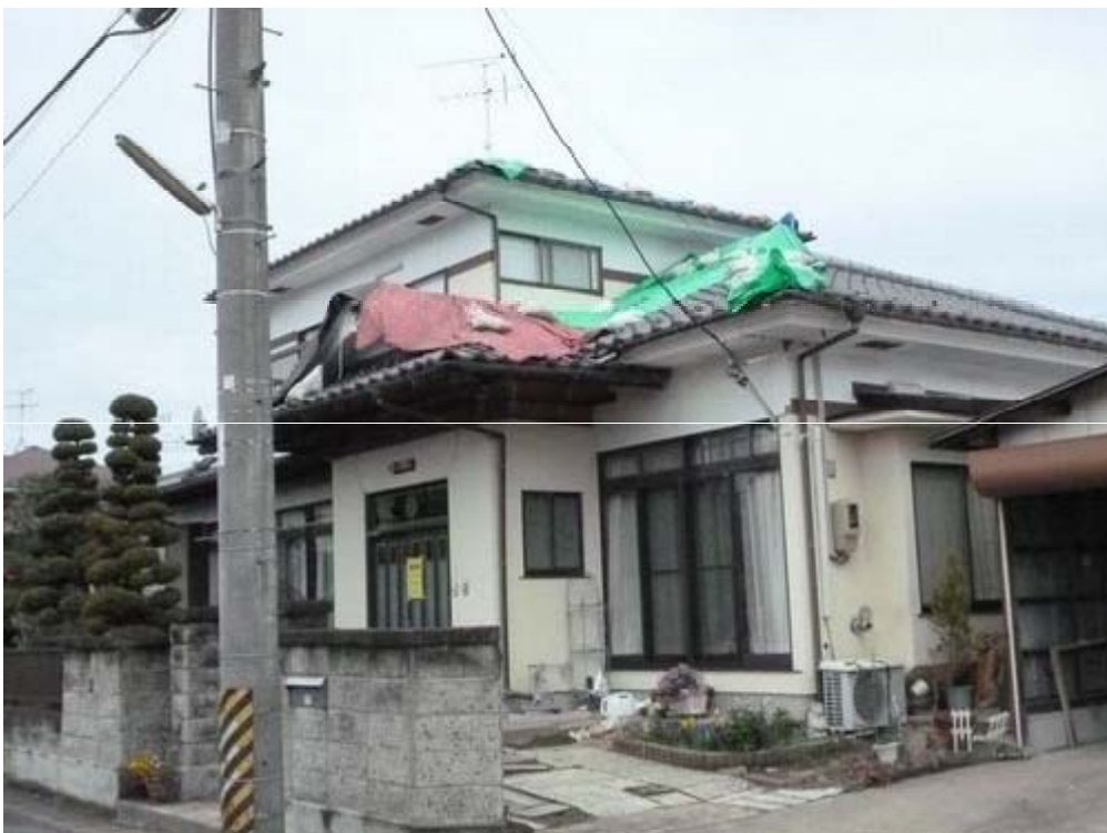
写真8 被災状況（瓦のずれ）
