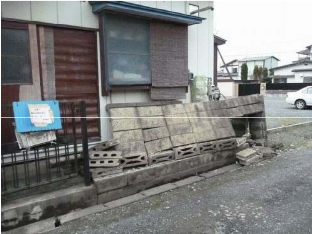
写真 1 1 被災状況（ブロック塀の倒壊）
