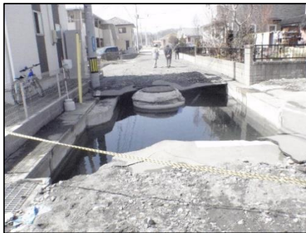
H23 東日本大震災による漏水の発生状況 柴田町内 (φ1,000mm)
