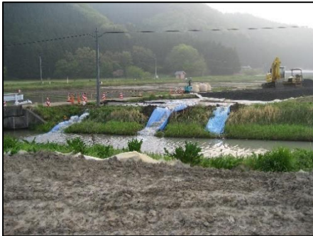
H20 軟弱地盤による漏水の発生状況 岩沼市内 (φ300mm)
