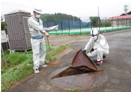
漏水現場（想定）の確認作業 （広域水道事務所の漏水事故対応訓練）
