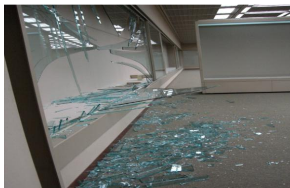
写真4 4月7日夜の余震で割れた本館1階展示室1の固定展示ケースガラス(鋭く尖った破片が6m先まで飛んでいた。)本震当時は、日本画を展示中。写真奥の本震による被害ガラスは撤去している。
