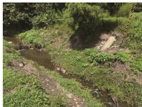
掘り起こしによって崩れた水路沿い
