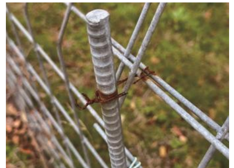
錆びて外れた結束線
