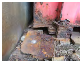
支承部の腐食
