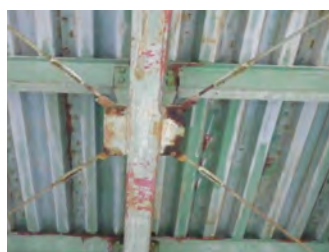
主梁部の腐食
