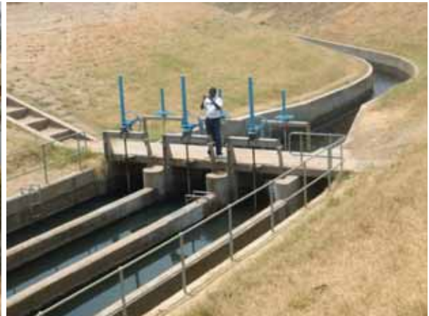
沈砂池と幹線水路
