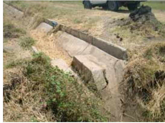
写真4：幹線水路末端の破損状況
