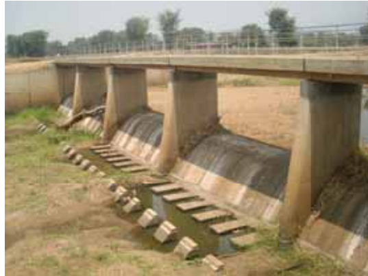
写真2：頭首工（奥に流木がある）
