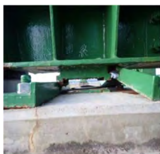
支承損傷状況
