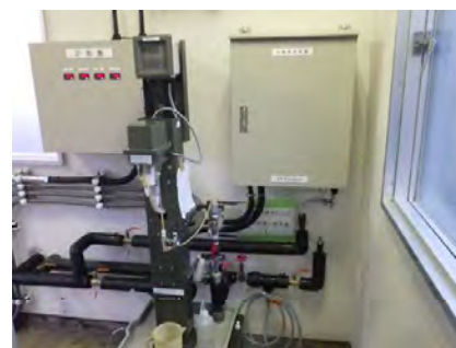
末端受水水質監視装置点検状況
