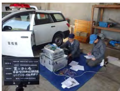
移動無線設備点検状況
