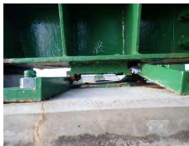
支承損傷状況
