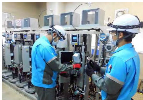
設備点検状況
