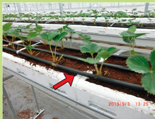
イチゴのクラウン(株元)加温用熱交換パイプの敷設状況(矢印で示した部分)
