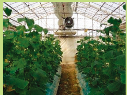
地中熱ヒートポンプおよび循環扇
