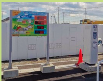
充電ステーション
