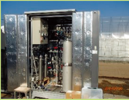
逆浸透膜装置(浄水量約25m 3 )
