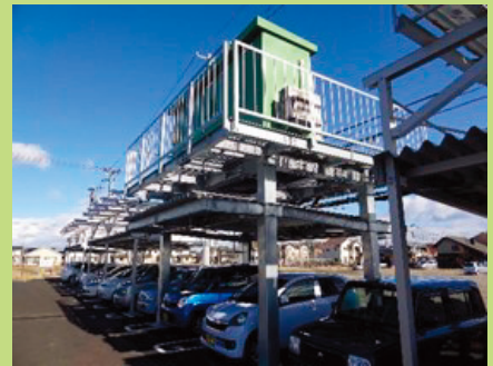
スーパーマーケットの駐車スペースに設置された太陽電池パネルと蓄電池
