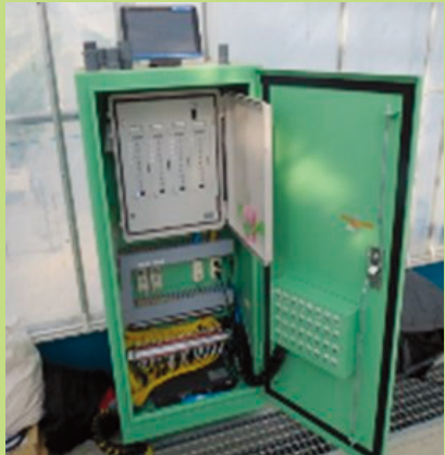
UECSの制御ノードBOX(富士通製)
