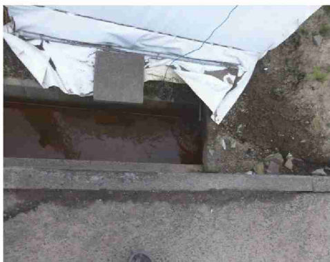
①排水の状況 (金気水)
