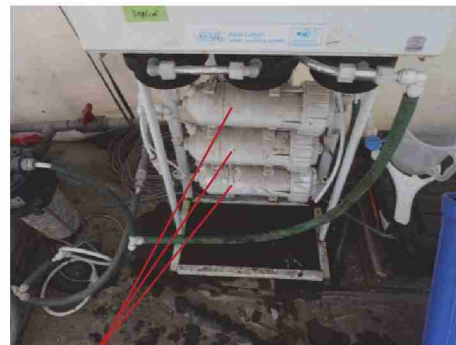
④逆浸透膜フィルターのケースを外す
