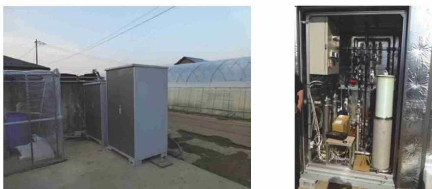
図 3.1 現地に設置した RO 装置（手前）および RO 装置の内部
