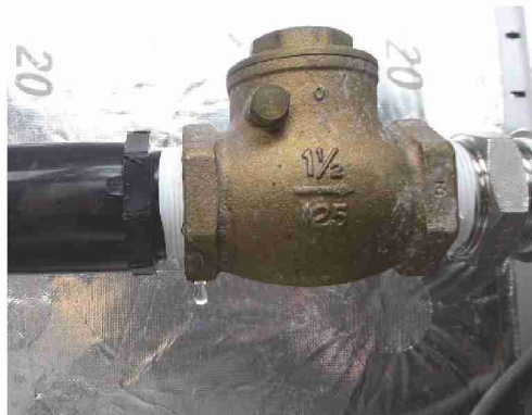
図 3.4 水漏れを起こしたポンプ 1 次側の逆止弁と塩ビ管バルブソケット
