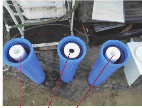
⑧1 μm、活性炭、5 μm フィルターケースに 新品を入れて元に戻す
