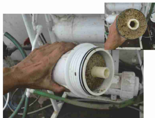
⑥中の逆浸透膜フィルターの状態
