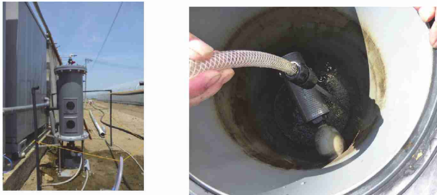
図 3.3 特注の砂取り器、直径 300mm 円筒容器内にストレーナ 3 個を設置 100 メッシュ SUS 製ストレーナは腐食するため年 1 回交換
