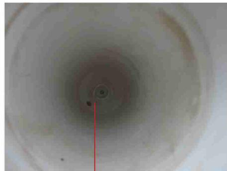
破損したフィルターケース (奥の円形の部分が変形)
