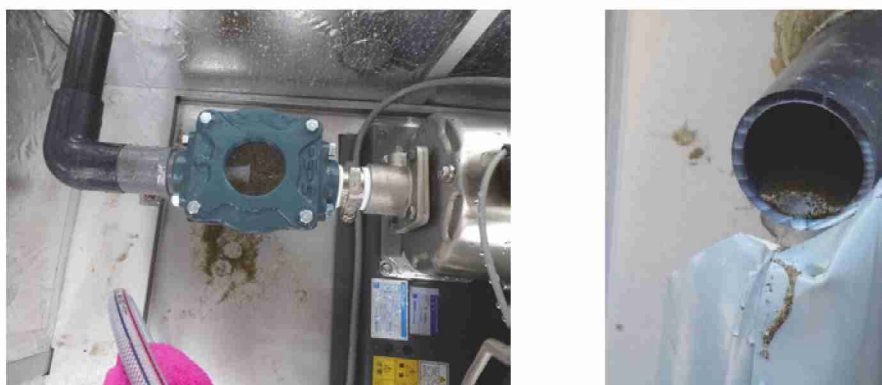
図 3.2 市販砂取り器と吸管内に堆積した砂
