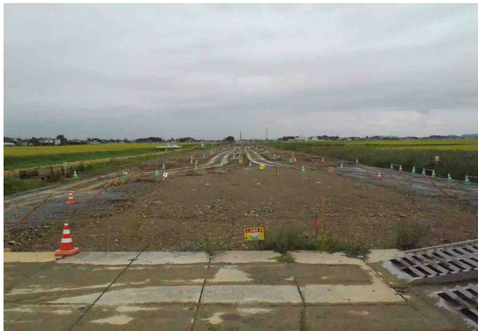
Ⅱ期（中田工区）終点部から起点方向（軟弱地盤対策工完了）
