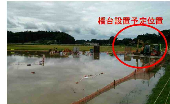
平成27年9月大雨による冠水状況
