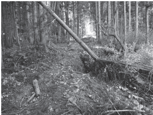
【南三陸町並石線】被災状況写真
