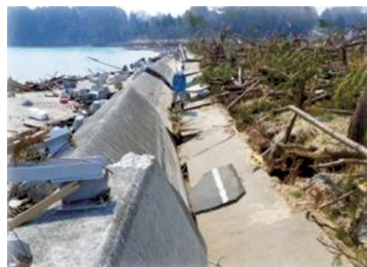
被災した防潮堤と海岸林
