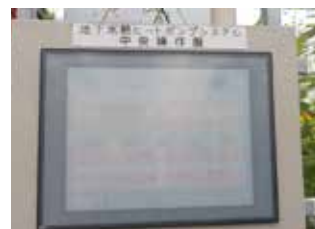
温度、日射量を制御する中央操作盤
