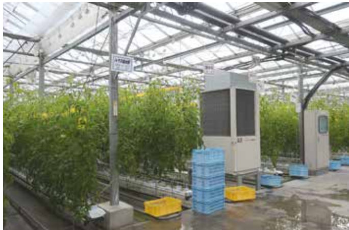
ハウス内、中央にあるのがヒートポンプ機器
