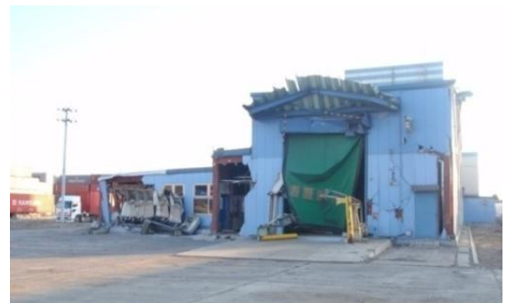
●被災した仙台コンテナ検査センター
