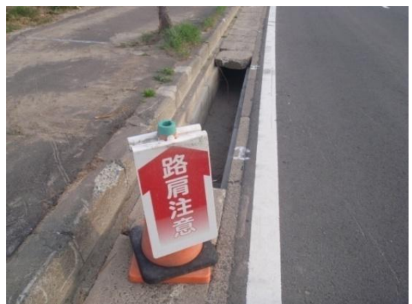
●蓋の外れた側溝
