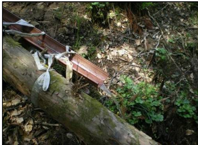
堤体漏水状況
