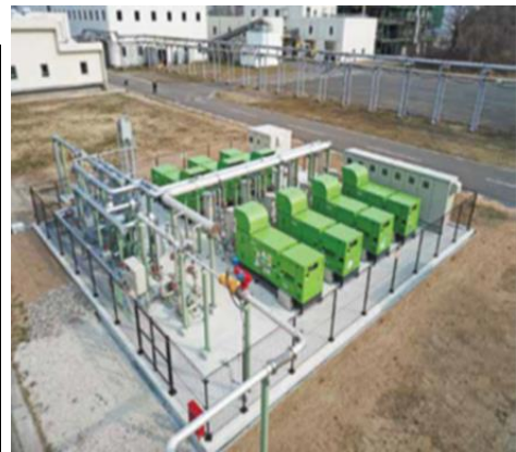
仙塩浄化センター 消化ガス発電所
