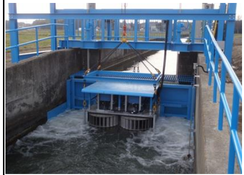
小水力発電設置例（内川小水力発電所）
