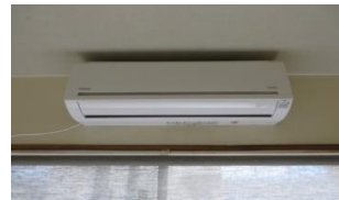
高効率空調機
