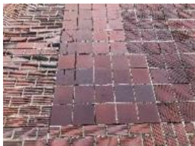
アプローチのタイル割れ
