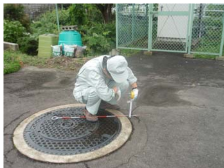
マンホールの段差確認1
