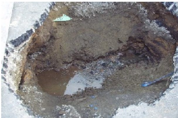
2007年8月に八幡で起こった陥没 （バス通りが10時間通行止め）
