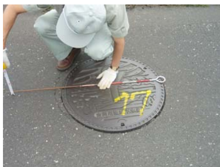
マンホールの段差確認2
