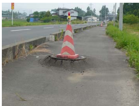
マンホール隆起
