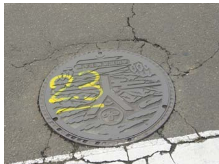
マンホール周辺の路面クラック発生！
