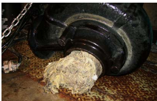
水中ポンプがしさにより閉塞
