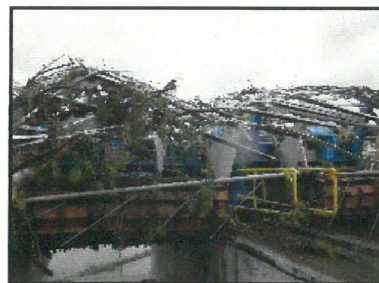
設備被災状況
