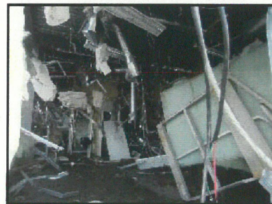
外部被災状況
