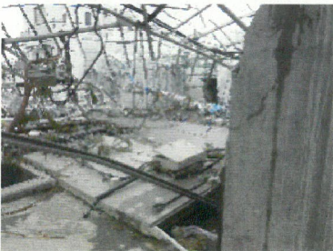
内部被災状況
