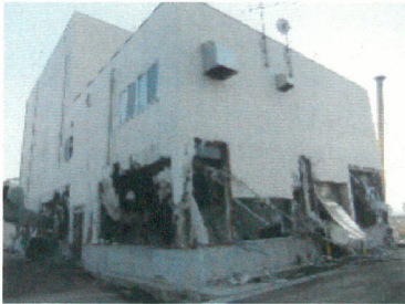
内部被災状況
