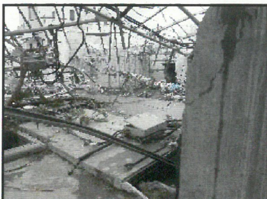
内部被災状況
