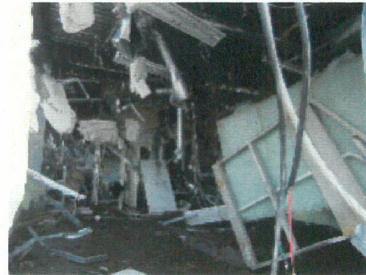
外部被災状況
