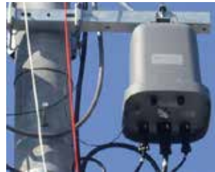
開閉器制御用子局
