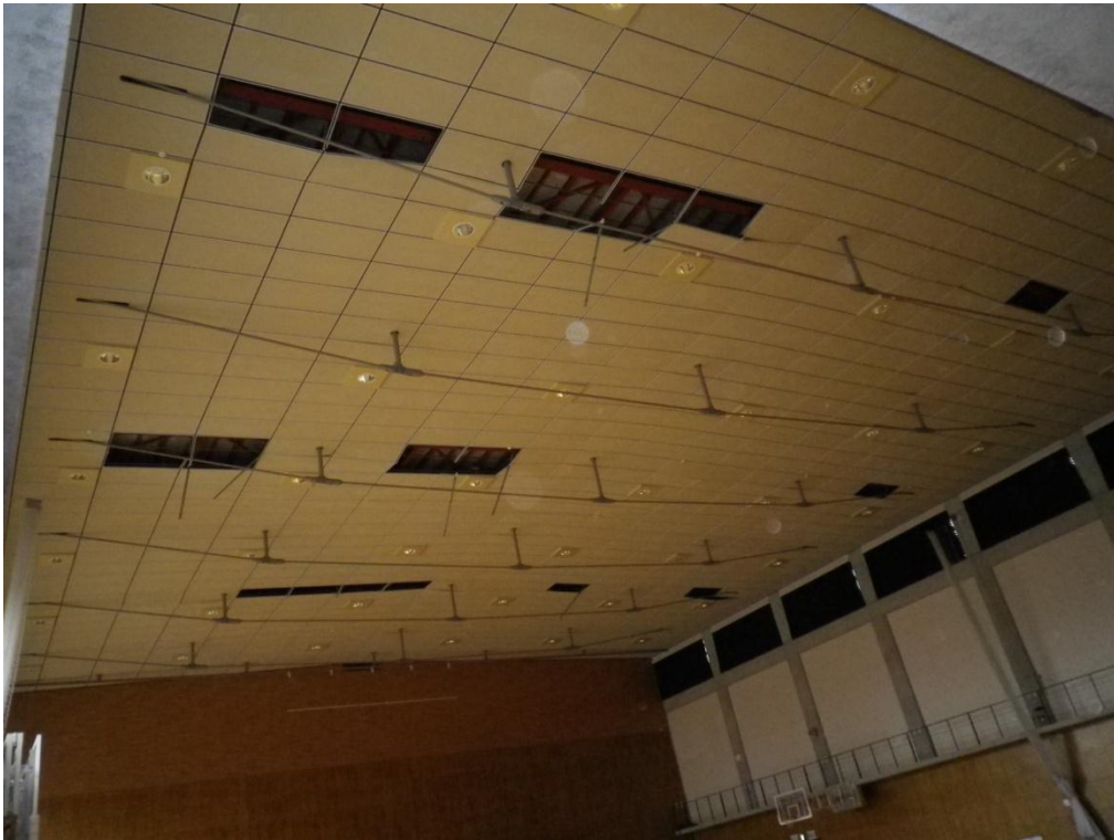
〈体育館天井ボード落下〉
