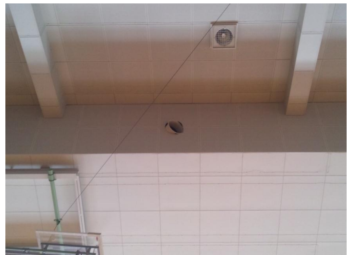
残って落下しそうな状態となっている危険部分
