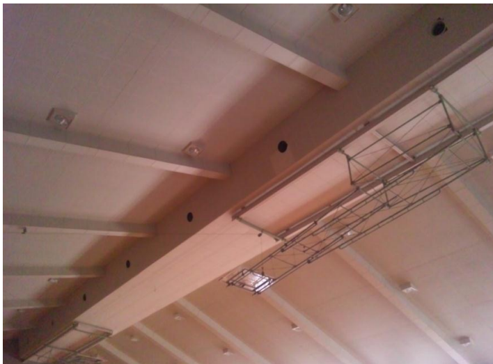
南側吹き出し口
