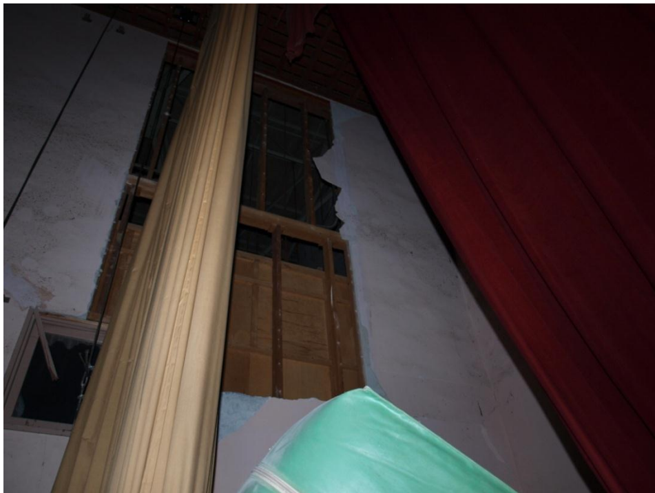
体育館ステージ脇 壁面のコンクリート落下
