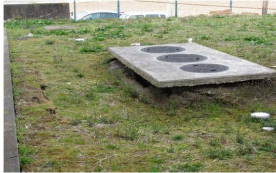
○体育館浄化槽周辺地盤沈下（浄化槽破損）
