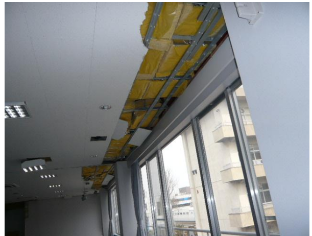
名北館(記念会館)天井ボード落下①
